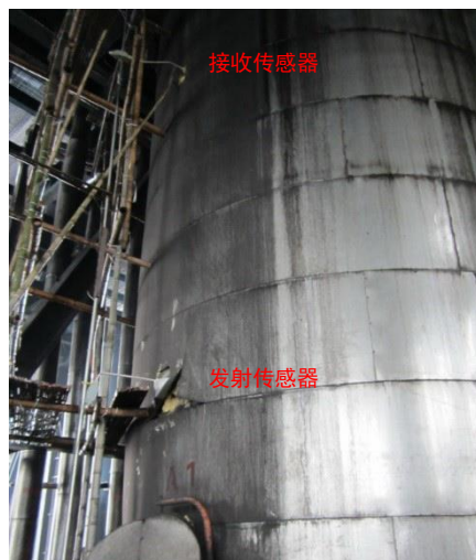
图 18 鼓泡塔液位检测工业装置实物图
